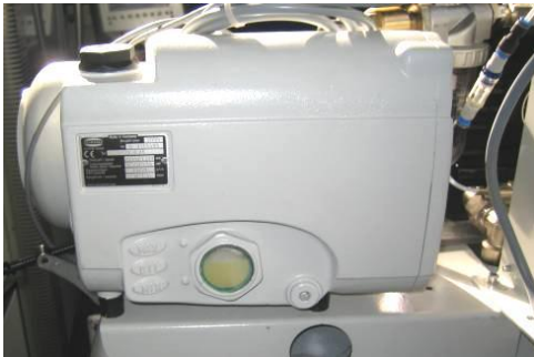
Vakuumpumpe mit Sichtglas (Ölstand)
